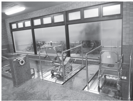
一般浴槽に設置された「ハートフル」
